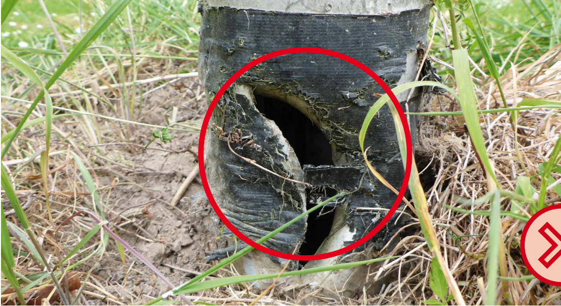
Bild 19: Deutliche Beschädigung am Pfosten
