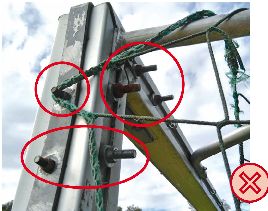
Bild 17: Überstehende Schrauben an Pfosten und Querlatte
