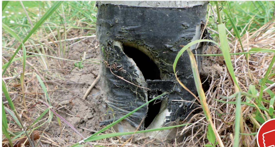
Bild 19: Deutliche Beschädigung am Pfosten
