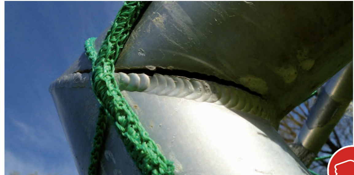
Bild 13: Riss an der Schweißnaht
