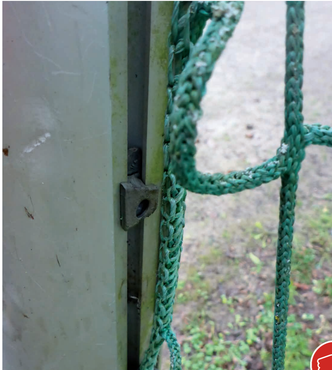
Bild 33: Gebrochene Kunststoffnetzaken sind auszutauschen.
